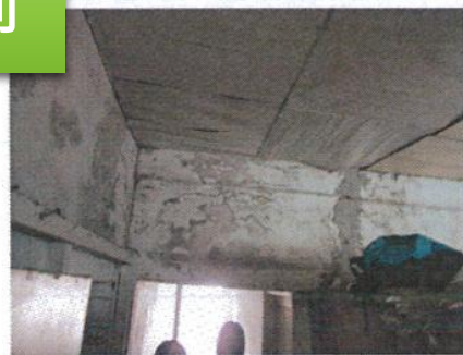
屋瓦破損坍塌，多處漏水
